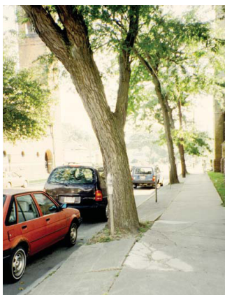
Fig. 1.10 Soulèvement du trottoir causé par la croissance de racines superficielles à Ithaca, NY / Levantamiento de aceras a causa del crecimiento de las raíces superficiales en Ithaca, NY.
